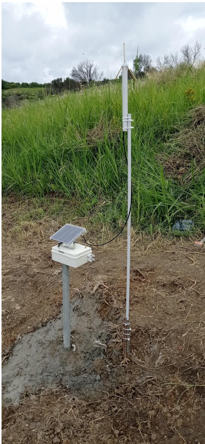
Figura 22 – Nodo sensore 49003 interrato per 1,5 m
